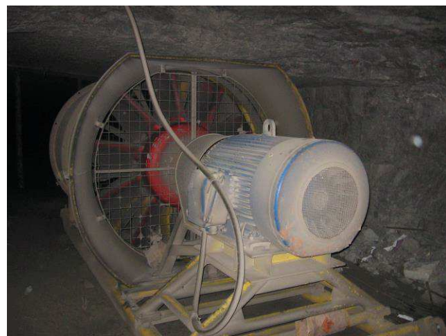
Wentylator dolowy, przewietrzający chodnik kopalni P=160 kW, 1500 obr/min
