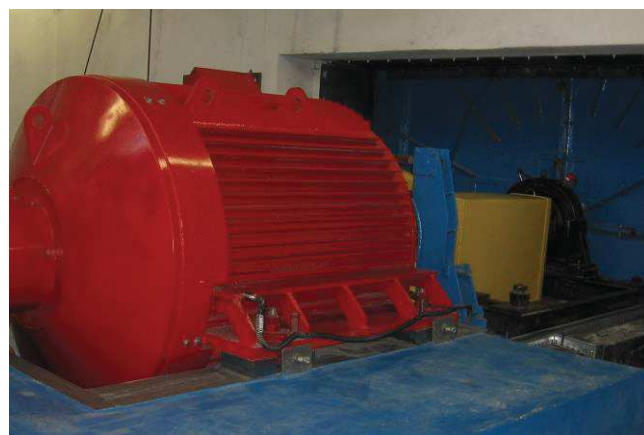
Napęd wentylatora głównego przewietrzania kopalni P=1100 kW, 500 obr/min
