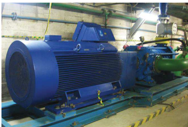
Napęd pompy głównego odwodnienia kopalni P=1600 kW, 1500 obr/min
